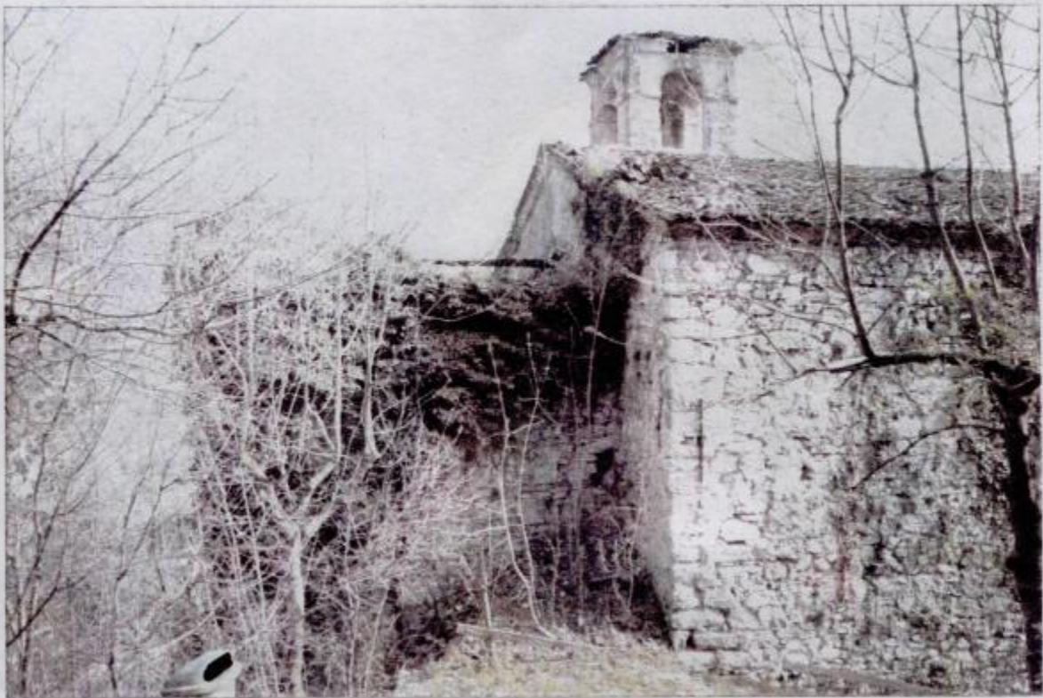
Esterno chiesa - particolare copertura abside crollata (foto marzo 2011)
